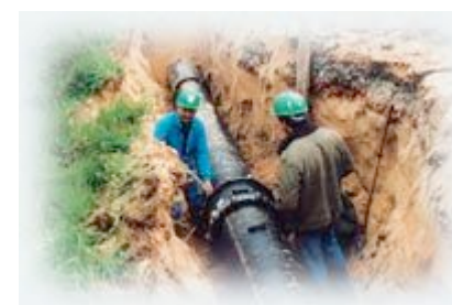
Ouvrage de transfert vers une ressource de substitution abondante
